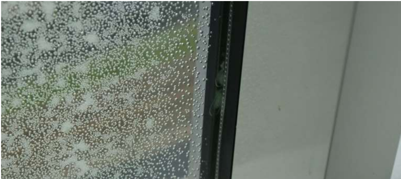
Uszkodzenie laminatu spowodowane wadą fabryczną folii
