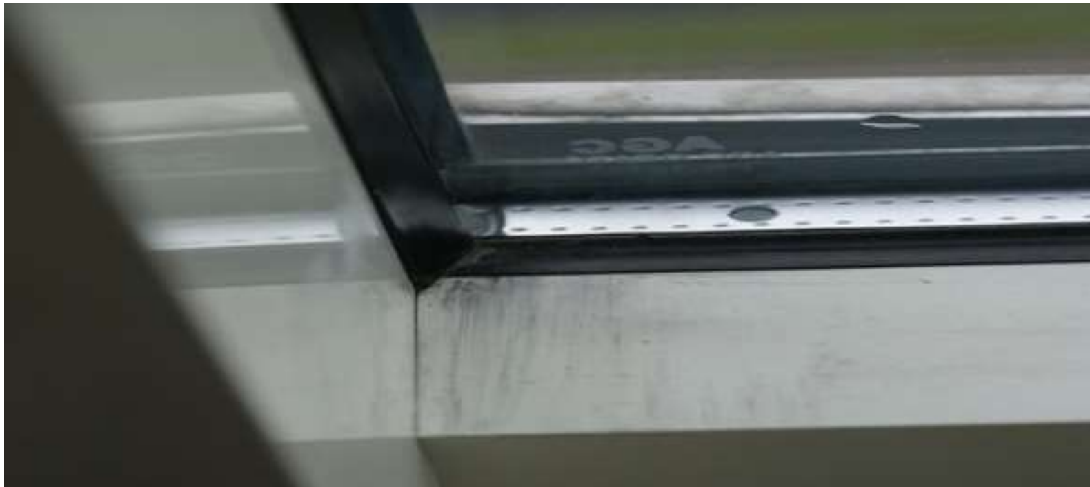
Nieprzylegające, źle spasowane uszczelki w narożniku okiennym
