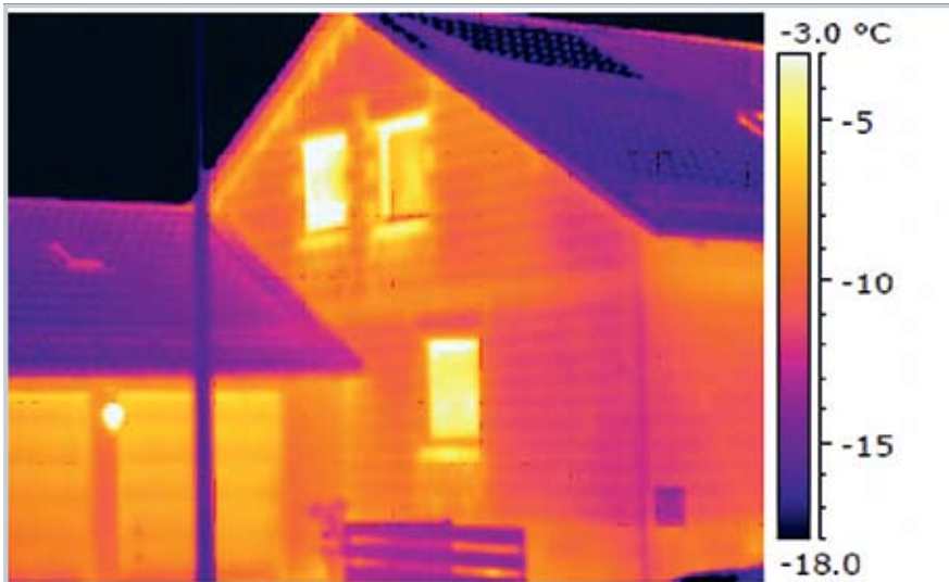
Popularne motywy: Często widzi się obrazy powłoki zewnętrznej budynku (fasady od zewnątrz). Pokazują one wiele szczegółów, ale najważniejsze kwestie ujawniają tylko badania termograficzne od wewnątrz.
